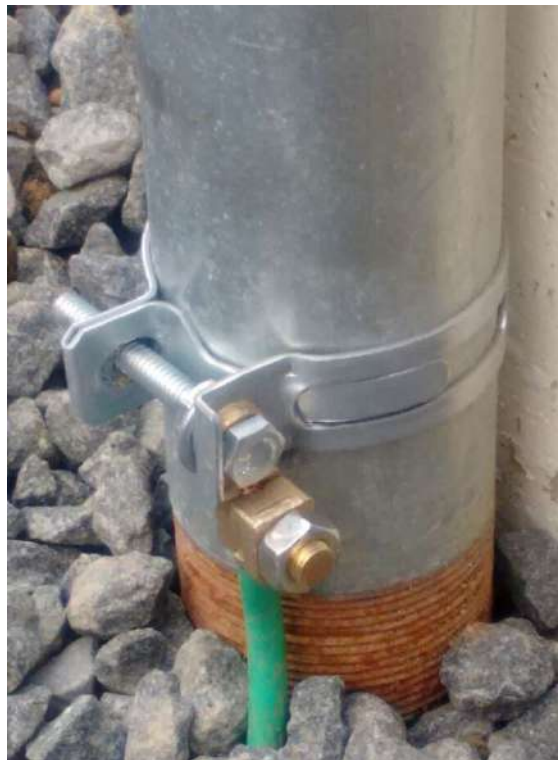
Foto ilustrativa 03 dos anexos G e H – Detalhe da abraçadeira de com terminal para aterramento
